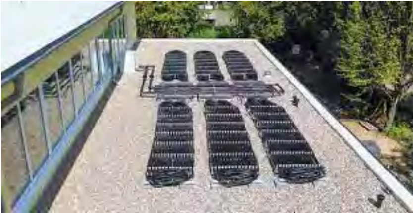
Luftabsorber auf Flachdach
